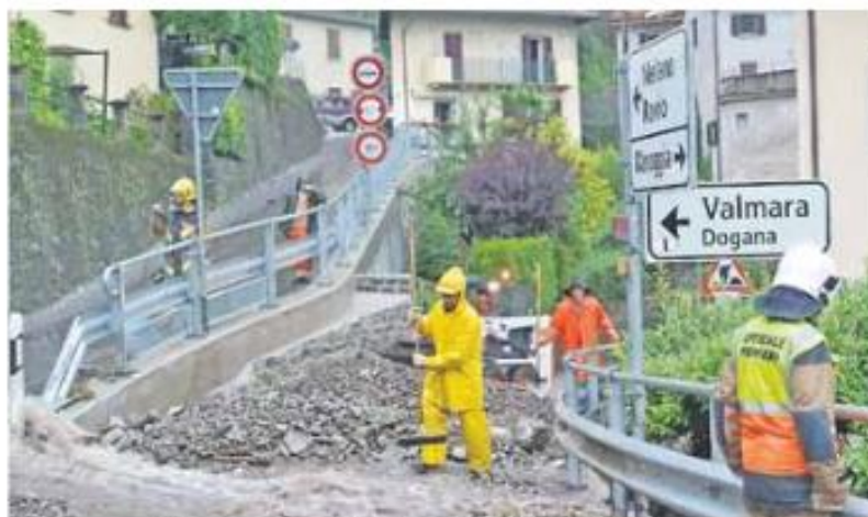
Alcune case di Arogno sono state minacciate dal fiume di fango. (Rescue M.)
