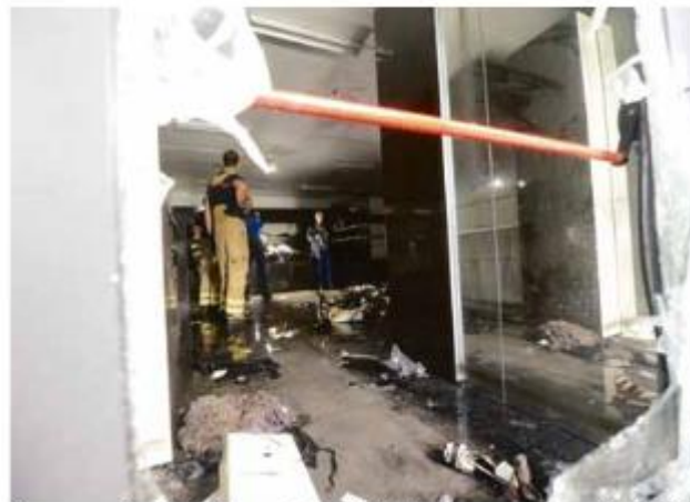
L'ingresso sul quale è stata constatata l'effrazione.
