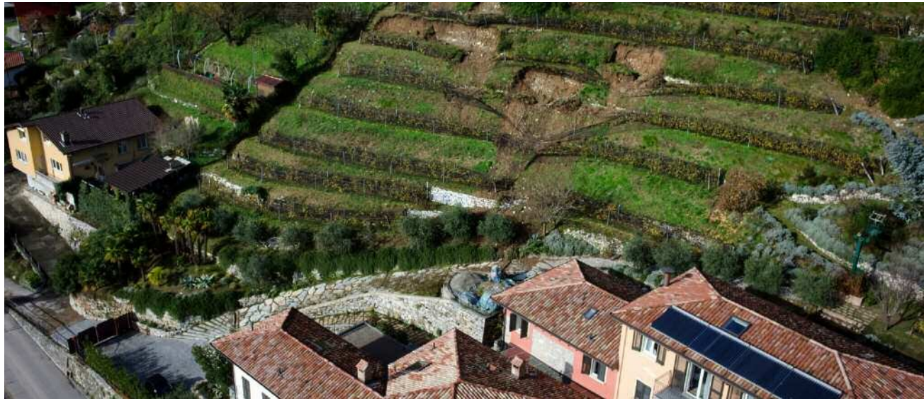
Prosegue la messa in sicurezza degli smottamenti avvenuti in un vigneto in zona Roggiana a Vacallo
