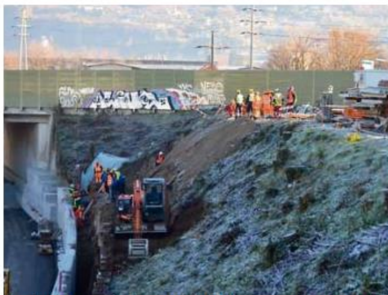
Il cantiere a Rancate dove è avvenuto l'incidente.
